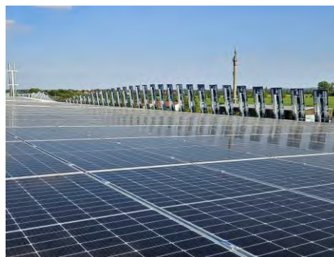
PV-Dach und Ansicht der Stahlunterkonstruktion mit PV-Elementen, die aus dem Dach herauskragen
