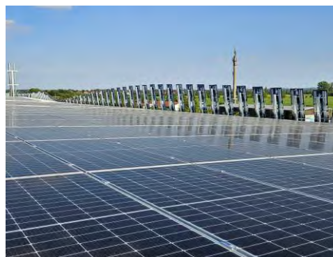
PV-Dach und Ansicht der Stahlunterkonstruktion mit PV-Elementen, die aus dem Dach herauskragen
